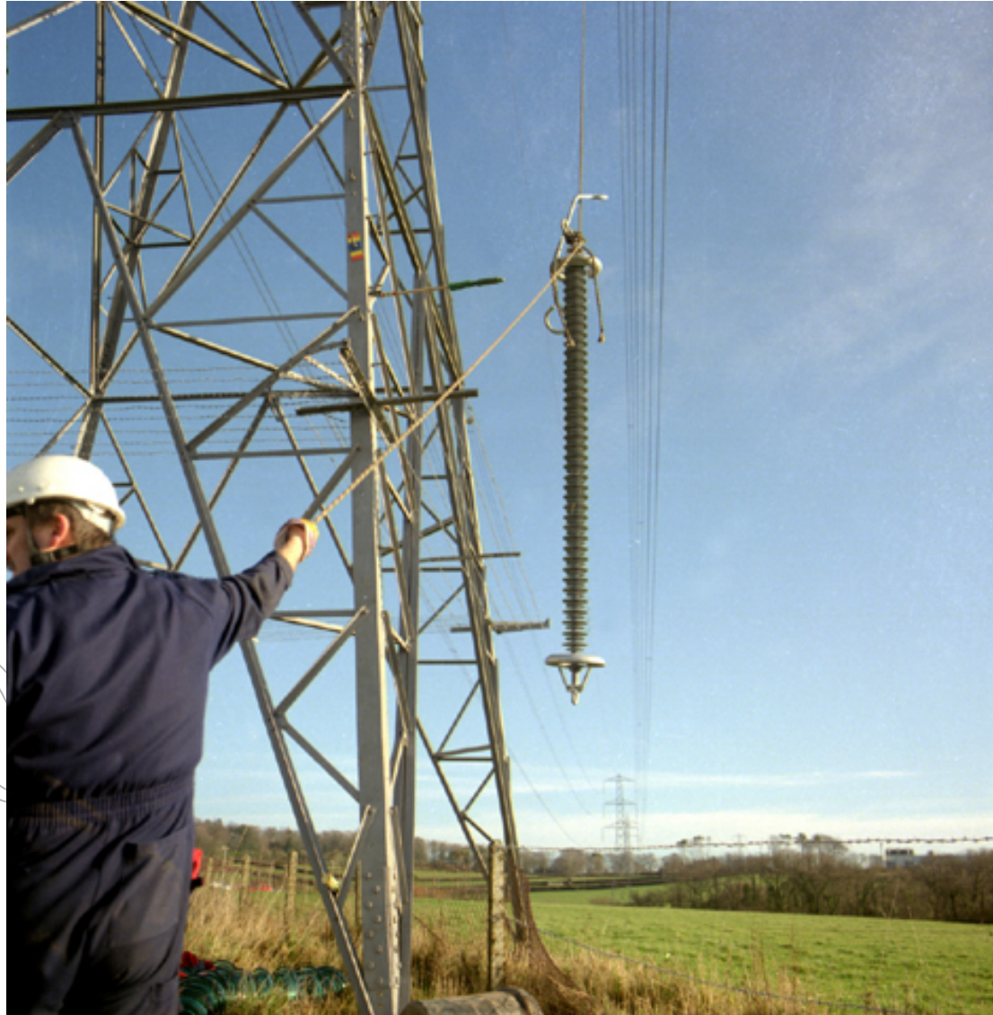
Vista izamiento de una cadena de aisladores
