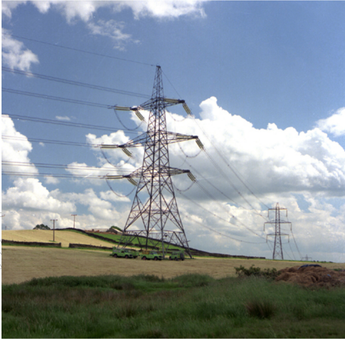
Vista general de torres doble circuito
